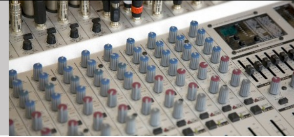
Audio- und Videotechnik sind bereits fest installiert
